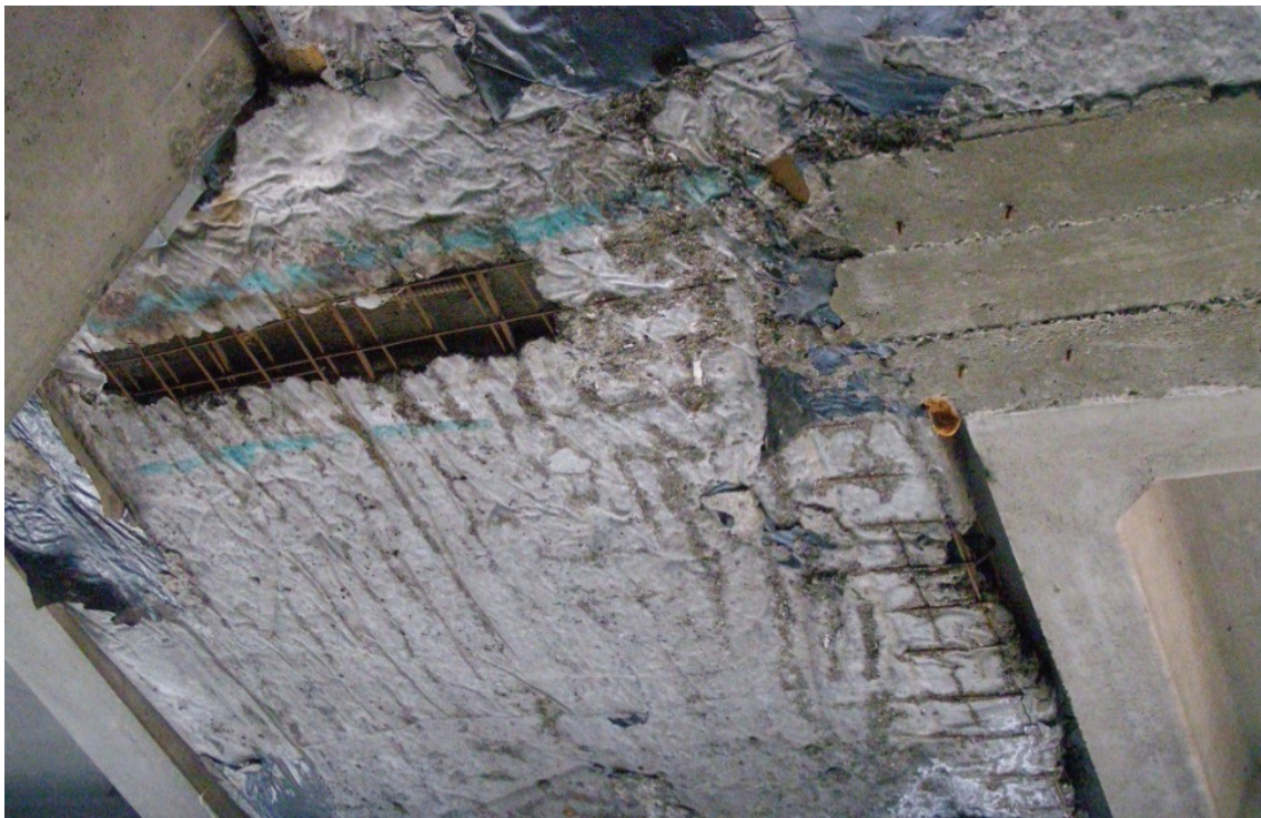
Рис. 11. Участки плит с неуплотненным бетоном и обнажением арматуры
