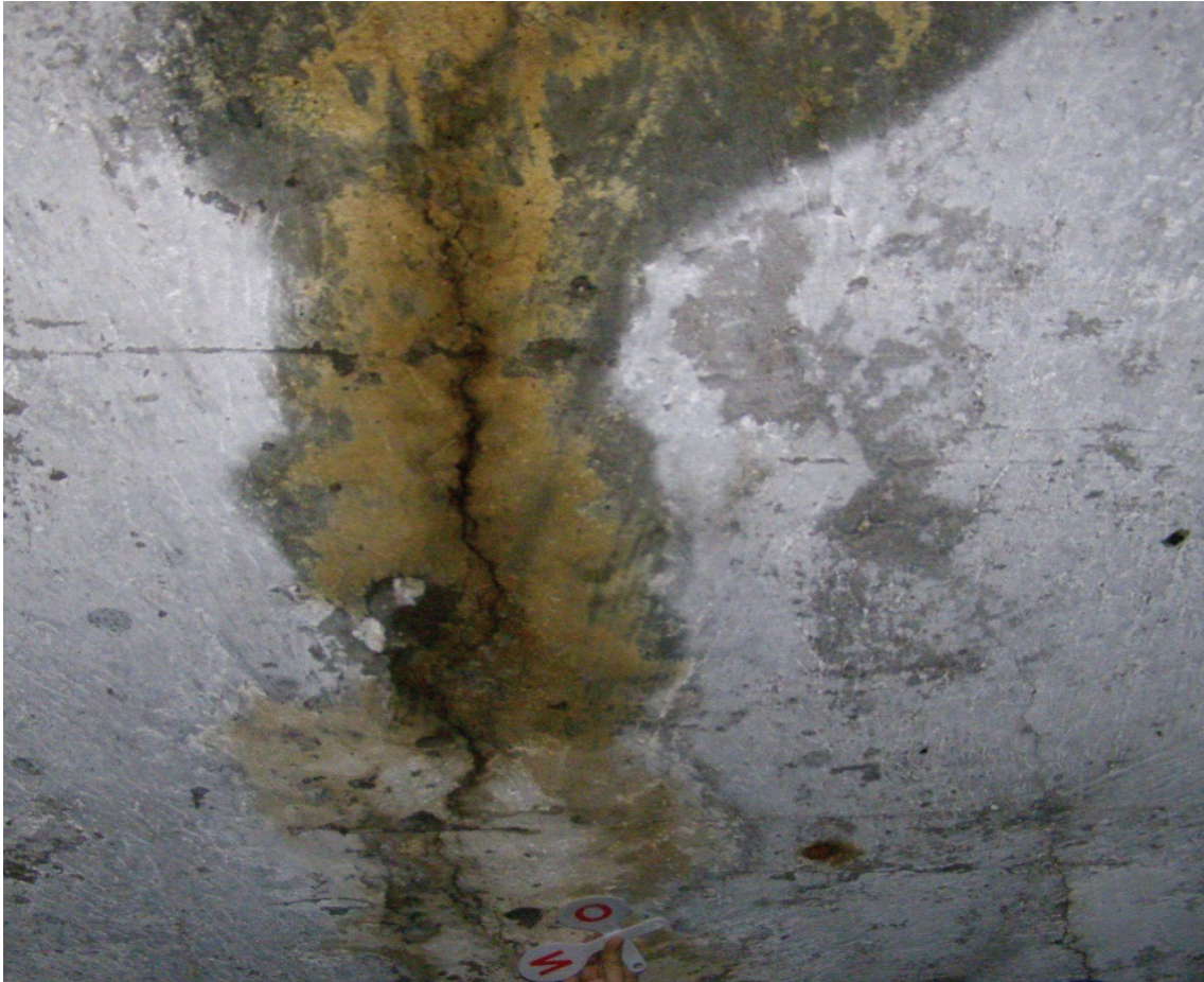
Рис. 10. Трещина снизу плиты перекрытия 1-го этажа в осях Е, Ж-8, V
