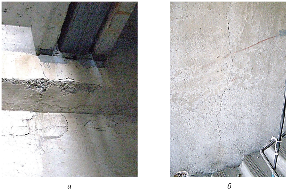
Рис. 13. Дефекты лестничных клеток
