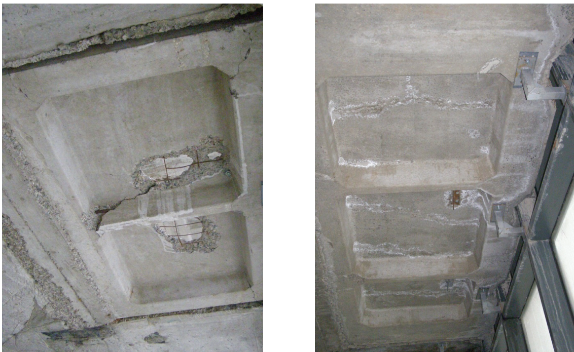
Рис. 12. Трещины, отверстия в полках и разрушение ребер балконных плит
