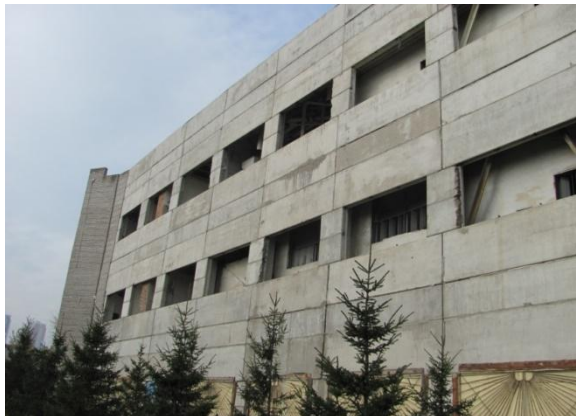
Рис. 5. Незавершенный объект на пр. Свободном
