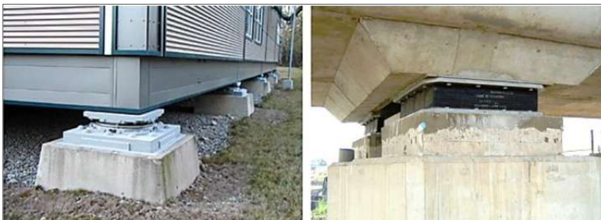
Рис. 3. Общий вид резинометаллических опор
