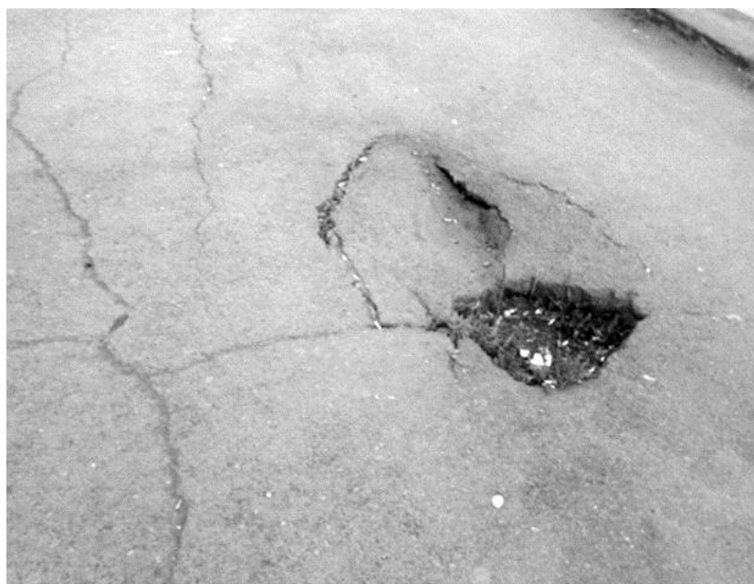
Рис. Глубокая суффозионная воронка на тротуаре (пр. Красноярский рабочий 78, г. Красноярск)
